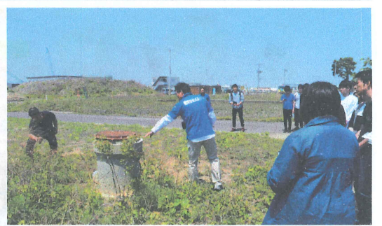
飛び出したマンホール
